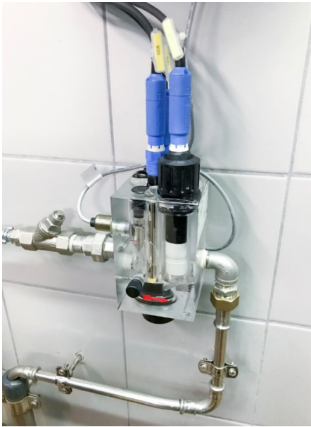
Abb. 2: Überwachung des Gehalts an freiem Chlor am Anfang des Verteilernetzes (Sensor Memosens CCS51D)
