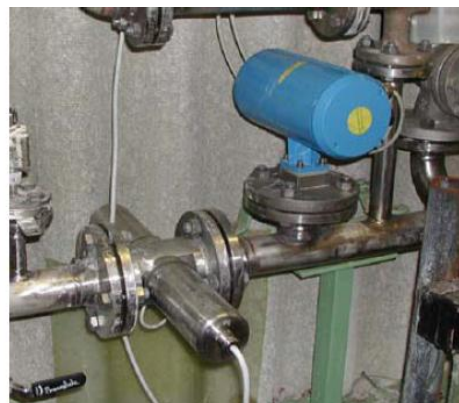
Schallsensor und Refraktometer in einer Rohrleitung
