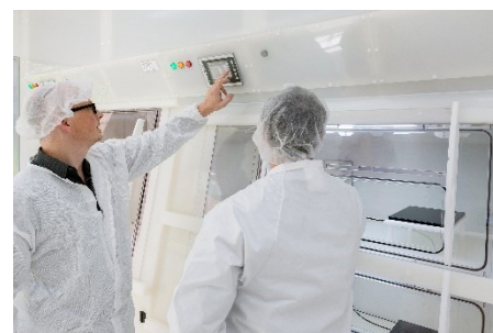
Abb. 4: Über integrierte Touch-Displays wird die Lüftungs- und Versorgungstechnik an den Arbeitsplätzen individuell gesteuert.
