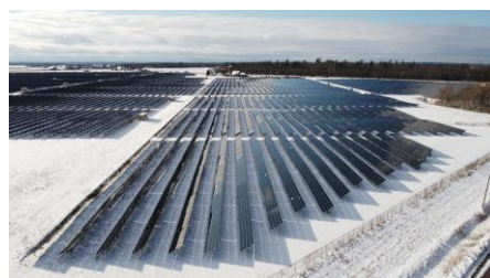
Bild 5: Fotovoltaik-Anlage. pexels [CC0]
